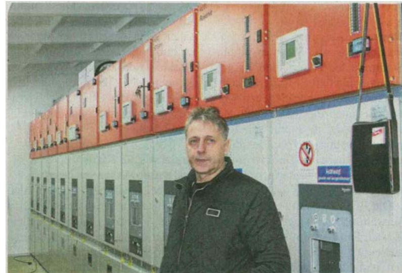
Das neue Umspannwerk beliefert die Eisenberger auch in der Corona-Krise weiter mit Strom.
