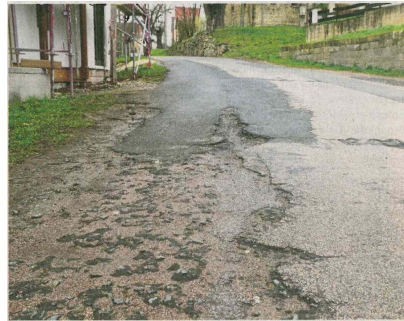
Die Ortsdurchfahrt in Buchheim soll auf mehreren Hundert Metern Länge erneuert werden.
