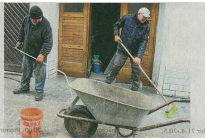
Mitarbeiter der Firma Bauer putzen gestern mit Wasser und Besen noch das neue Pflaster in der Johannissgasse.
