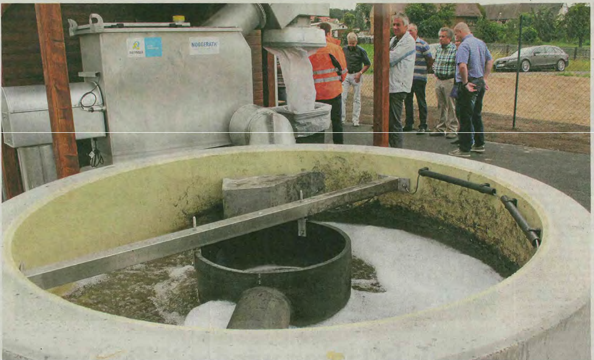
Die Kläranlage für Mertendorf hat der Zweckverband Trinkwasserversorgung und Abwasserbeseitigung Eisenberg (ZWE) gebaut als Pilotprojekt für autarke zentrale Abwasserlösungen für einzelne Dörfer. In seiner Investitionsplanung bis 2013 hat der ZWE weitere Dorf-Kläranlagen vorgesehen Archivfoto: Angelika Munteanu
