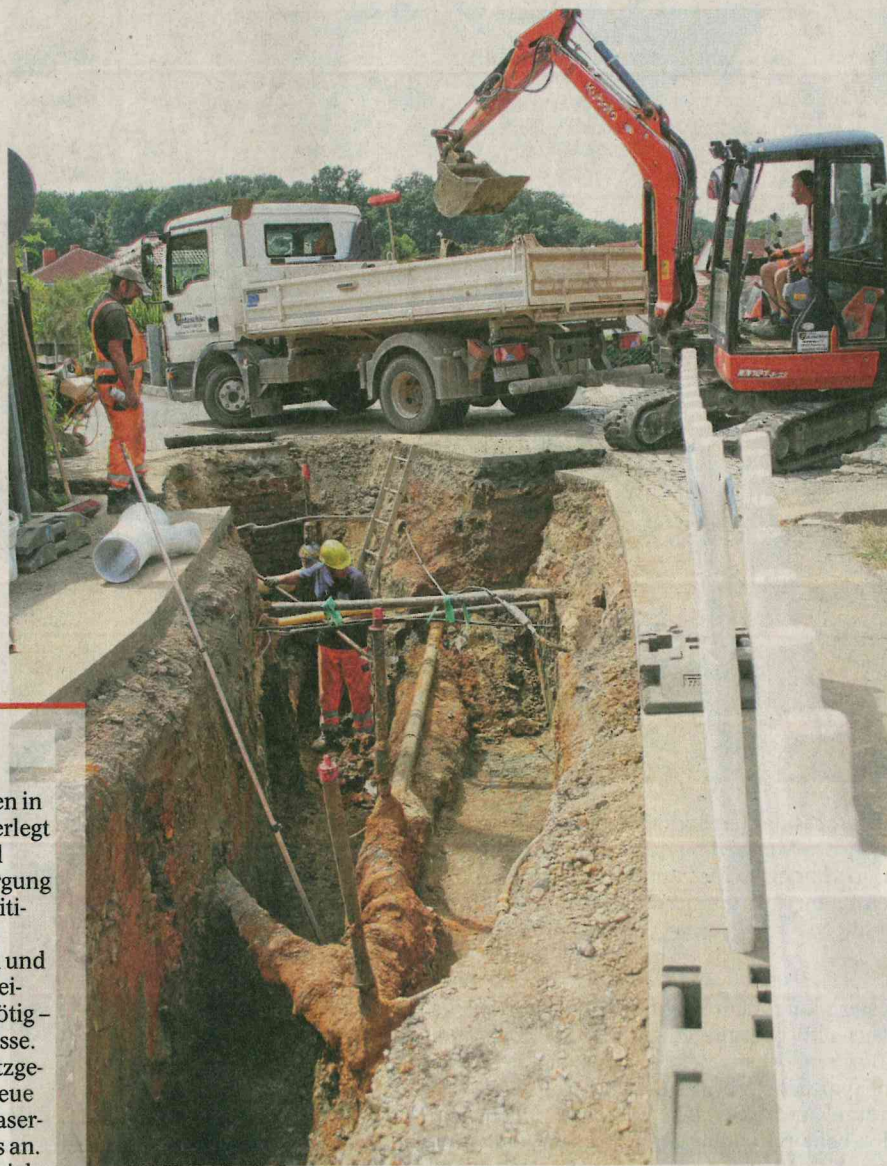
Das enge Baufeld in der Eisenberger Grenzstraße erfordert zum Teil Handschachtungen in einer Tiefe bis zu drei Metern. Foto: Angelika Munteanu
