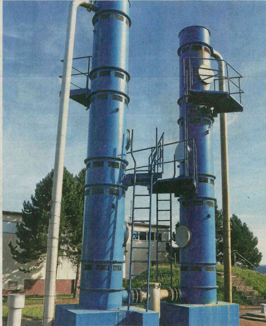
Der Zweckverband Trinkwasserversorgung und Abwasserbeseitigung Eisenberg (ZWE) will ab 2018 das Wasserwerk Ullrichsberg modernisieren. Foto: ZWE
