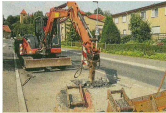
Die Baustelle in Hartmannsdorf auf der L 3007 soll bis zum Wochenende fertig sein. Foto: A. Munteanu
