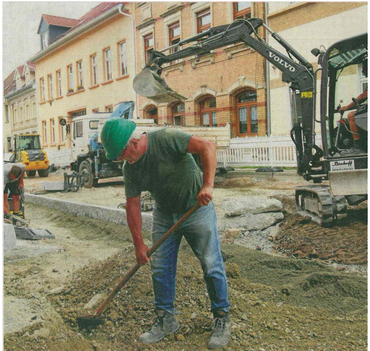
Altstadtsanierung in Eisenberg: Auf der Baustelle in der Karl-Liebknecht-Straße wird der Untergrund für das Granitpflaster vorbereitet, das ab heute gelegt wird.
