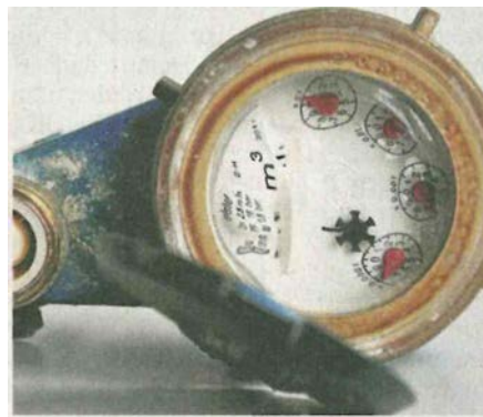
Ein unsachgemäß aufgetauter Wasserzähler, dessen Innenleben total zerstört ist.
