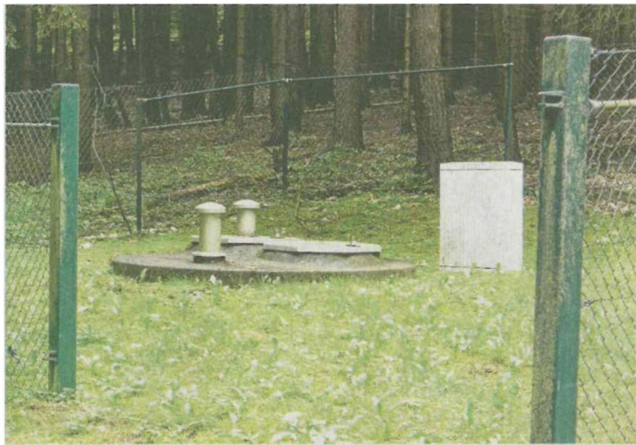
Der Tiefbrunnen Stangenberg des Zweckverbandes Trinkwasserversorgung und Abwasserbeseitigung Eisenberg. Das Eingangstor wurde gestohlen. Foto: ZWE
