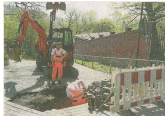
Am Geyersberg/Kreuzung Oststraße wird voraussichtlich noch bis Mittwoch gebaut. Foto: U. Flamich
