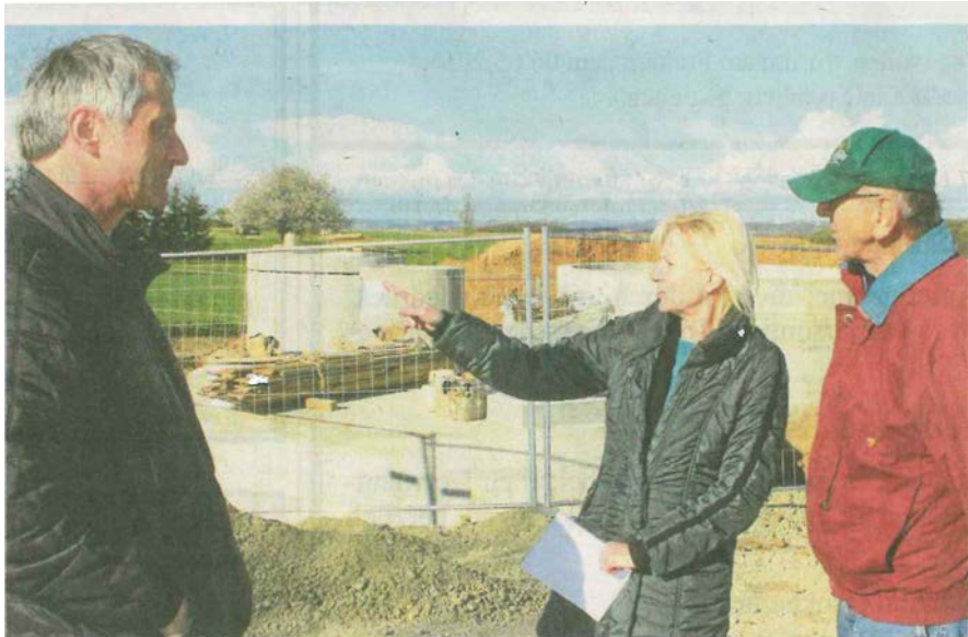
An der Baustelle für eine zentrale Kläranlage in der Gemeinde Mertendorf: Andreas Kratsch und Ute Böhm von der Geschäftsleitung des Zweckverbandes Trinkwasserversorgung und Abwasserbeseitigung Eisenberg (ZWE) und der Anwohner Edgar Wiesner (von links). Foto: Angelika Munteanu
