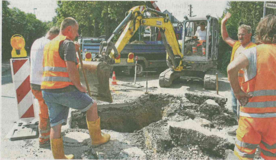
Auf eine Unterspülung stießen gestern Bauarbeiter bei einer Straßenreparatur in Eisenberg. Mehr Fotos unter: www.otz.de Foto: Ute Flamich
