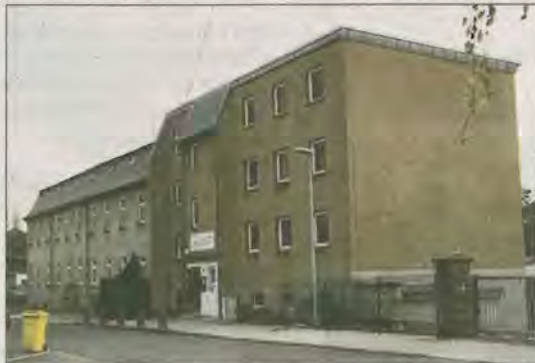
Alt und trist wirkt die Fassade des ZWE-Gebäudes in Eisenberg. Foto: Ute Flamich
