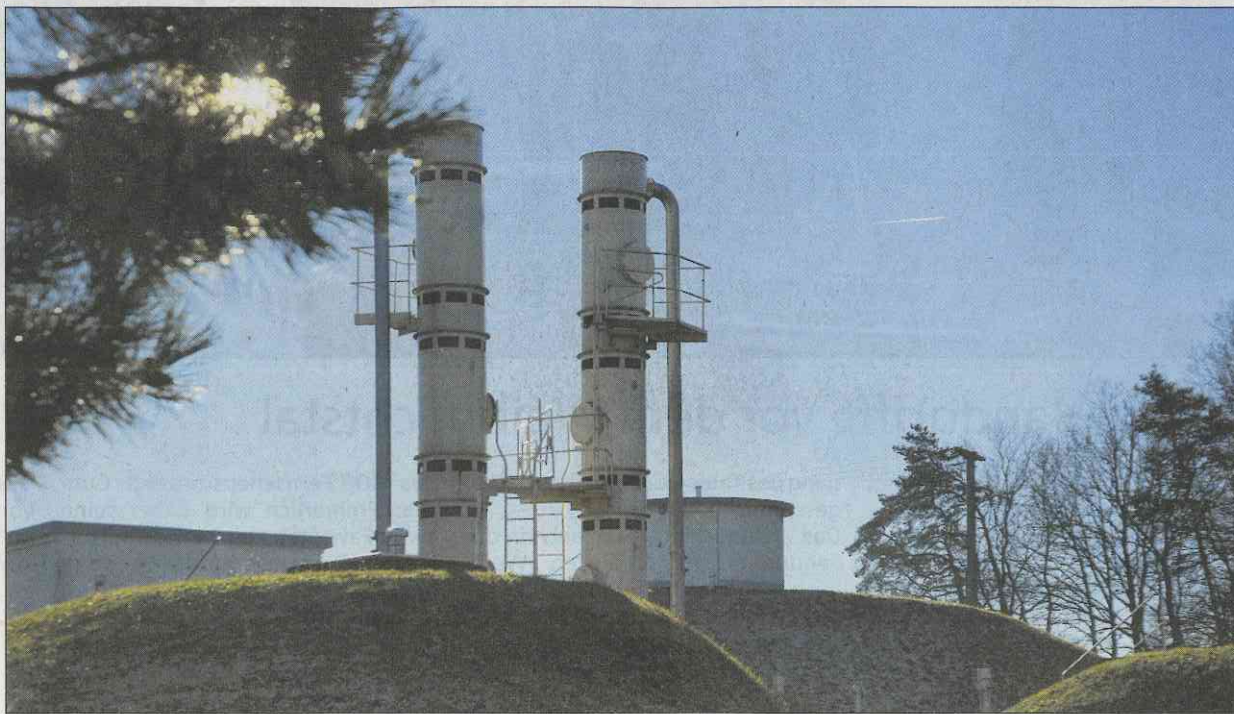
Das Wasserwerk Ullrichsberg gehört zu den zentralen Anlagen des ZWE. Dort wird Wasser aus dem Wethautal aufbereitet und weitergeleitet.
